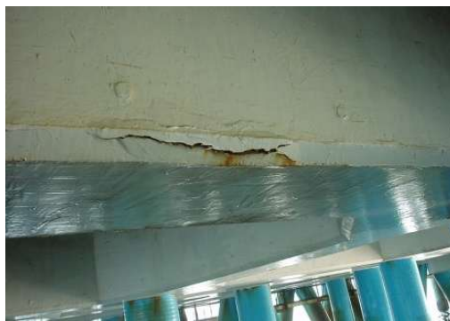
Hình 3.4.3 Xuất hiện vết nứt do suy thoái tái diễn sau khi áp dụng phương pháp phủ bề mặt
