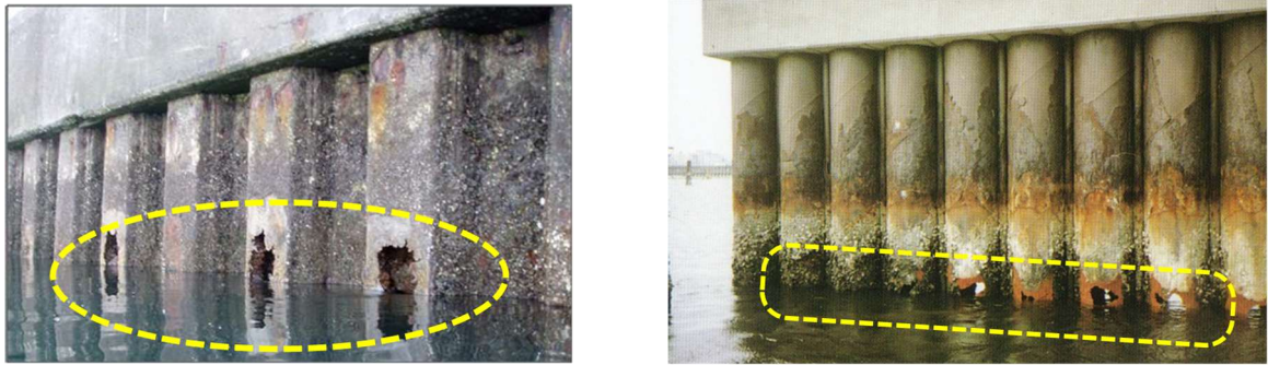
Ảnh 3.5.6 Ăn mòn rỗ do ăn mòn cục bộ trong kết cấu thép không được bảo vệ 5)
