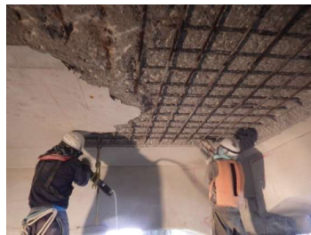
Ảnh 9 Loại bỏ bê tông bị hư hỏng tại mặt dưới của bản sàn
