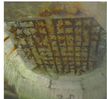
Ảnh 2 Tình trạng hư hỏng của kết cấu thượng tầng cầu cảng (mặt dưới của bản sàn)
