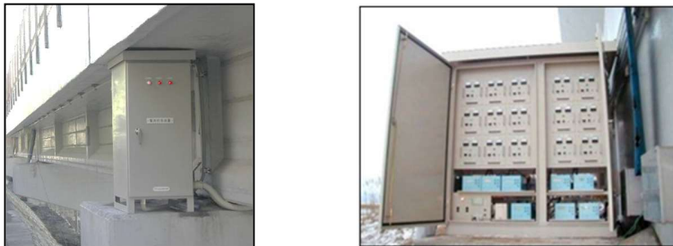
Ảnh 7 Lắp đặt bộ nguồn điện một chiều
